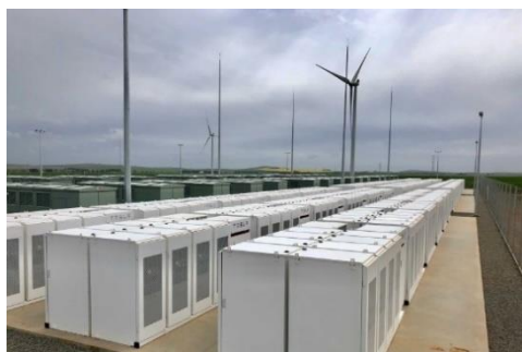
Figuur 7.1 Lithium-ion batterij complex Australië (450MWh)
