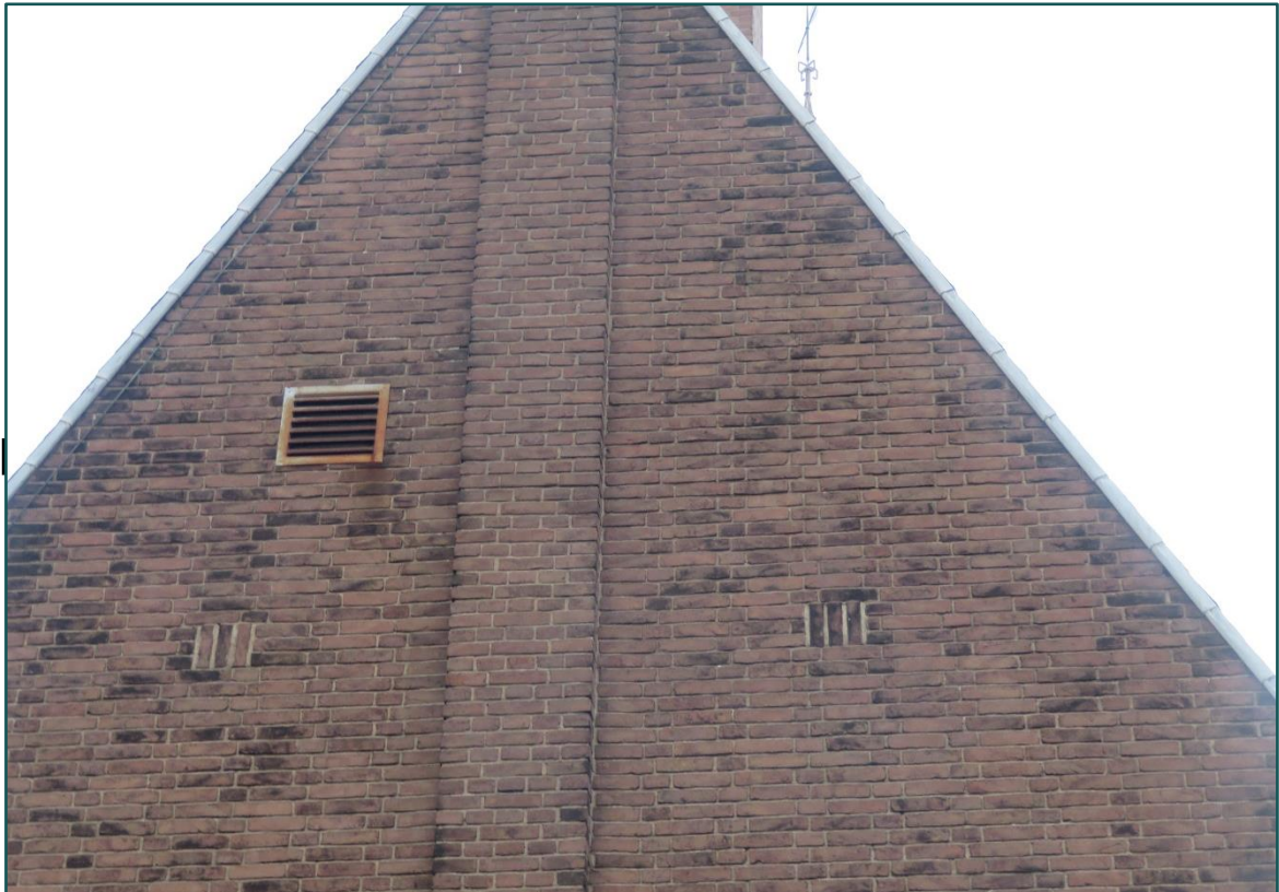
Figuur 3 De luchtroosters zijn ontoegankelijk.
