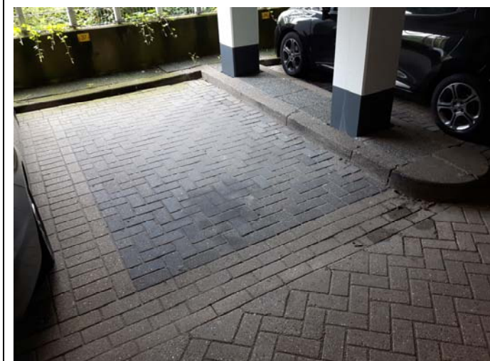
Foto 15: Olieplekken op verharding parkeergarage
