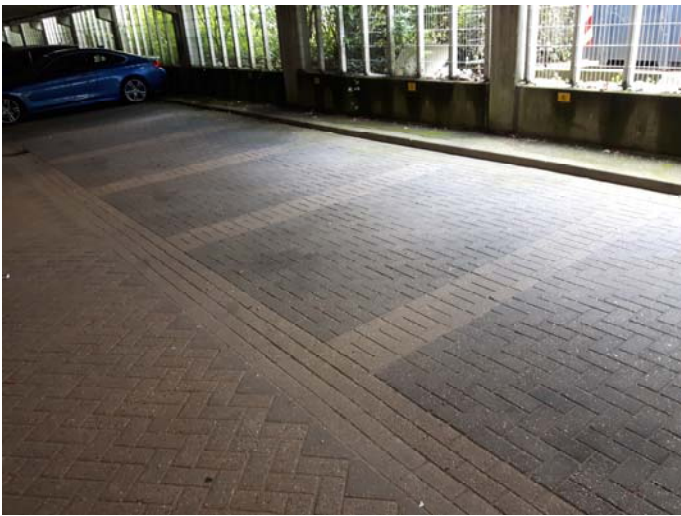
Foto 17: Olieplekken op verharding parkeergarage
