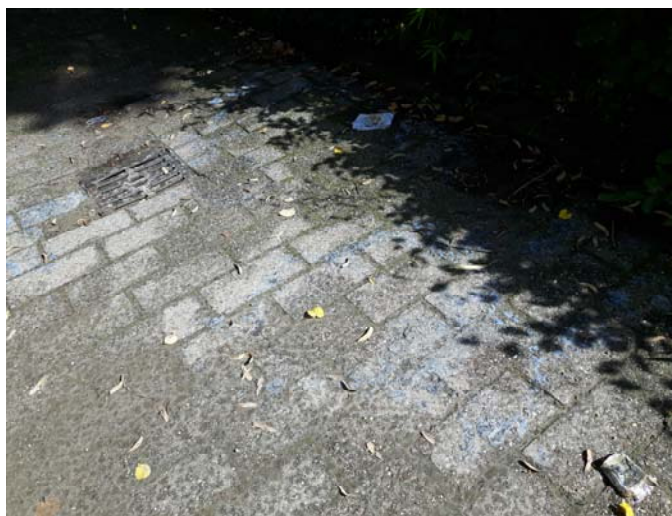
Foto 10: Verfresten op maaiveld thv containerruimte
