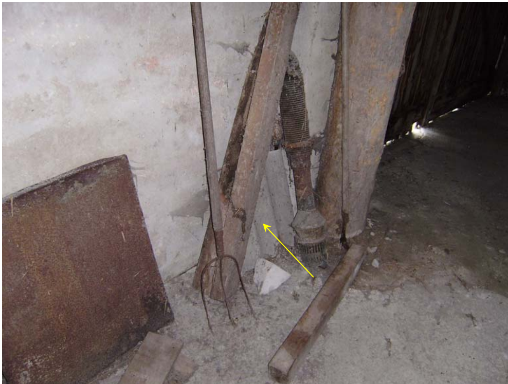
Foto 5: Gezicht op een stuk asbestverdacht golfplaatmateriaal.
