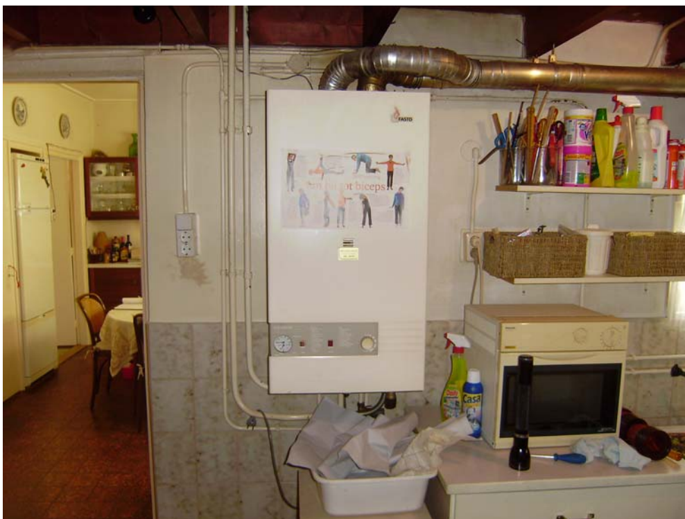
Foto 6: Gezicht op de mogelijk asbesthoudende cv-ketel.
