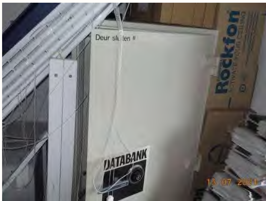
Foto 1: Bron B01, kluis met mogelijk asbesthoudende isolatie
