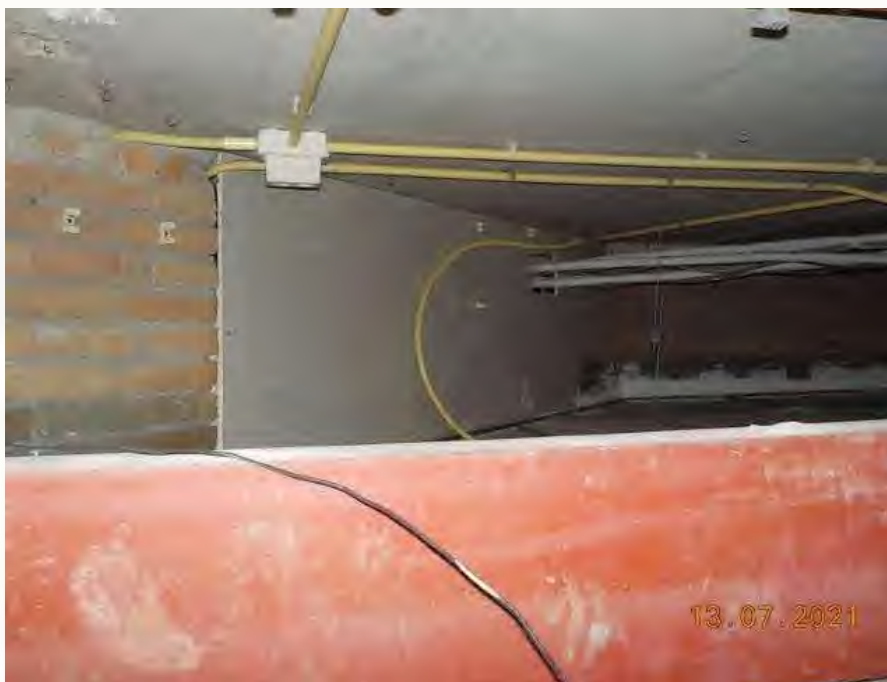
Foto 18: Asbestvrije gipsbeplating als brandscheiding
