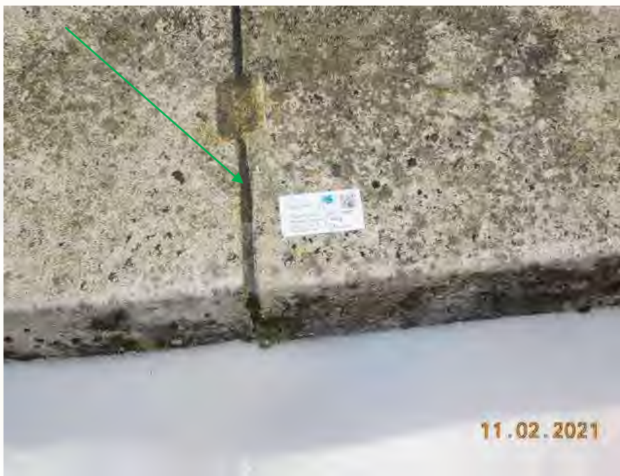
Foto 12: Bron B05, asbestvrije kit in naden dakrand
