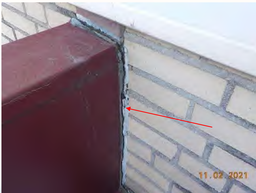
Foto 2: Bron B01, asbesthoudende kit bij balustrade, 2 de etage
