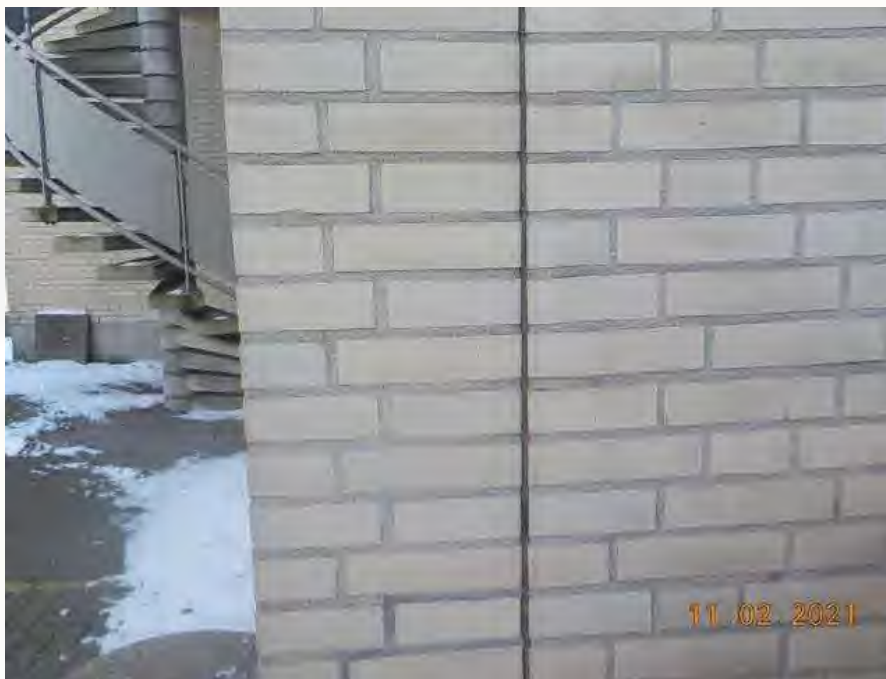
Foto 22: Bron B11, asbestvrije dilatatievoeg, kit
