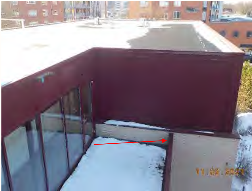
Foto 1: Bron B01, asbesthoudende kit bij balustrade, 2 de etage
