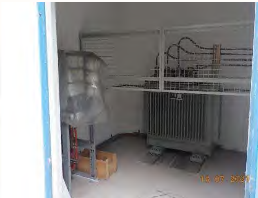
Foto 26: Hoogspanningsruimte, Noodstroom in beheer van Liander
