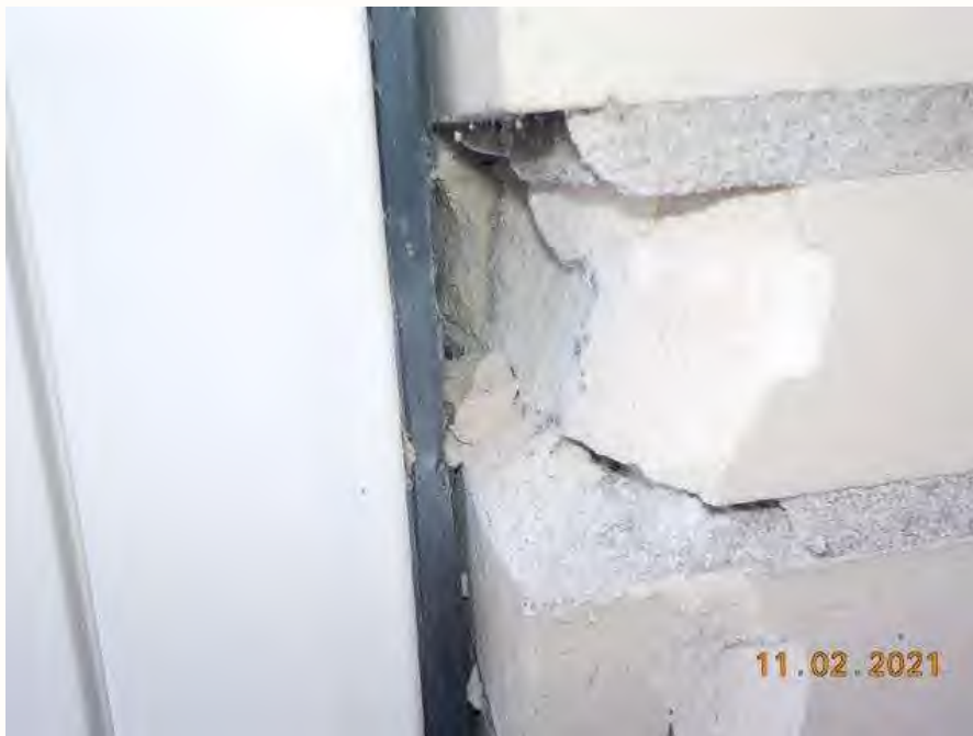
Foto 21: Bron B10, asbestvrije bitumen slab in spouwmuur
