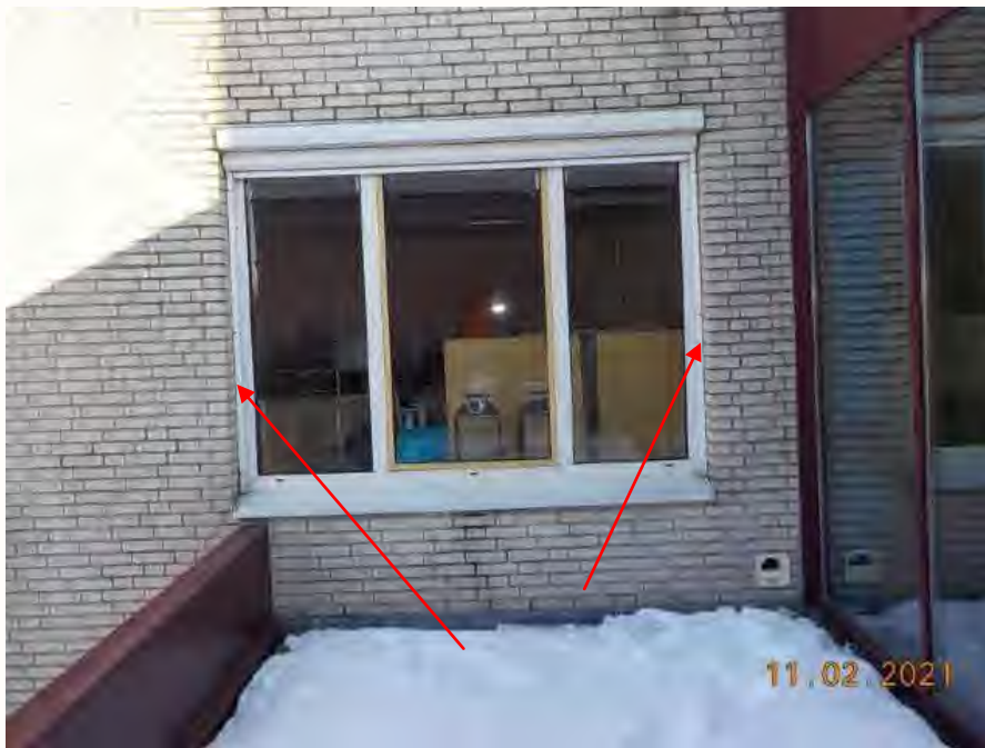
Foto 27: B02, asbesthoudende kit langs aluminium kozijnen met metselwerk
