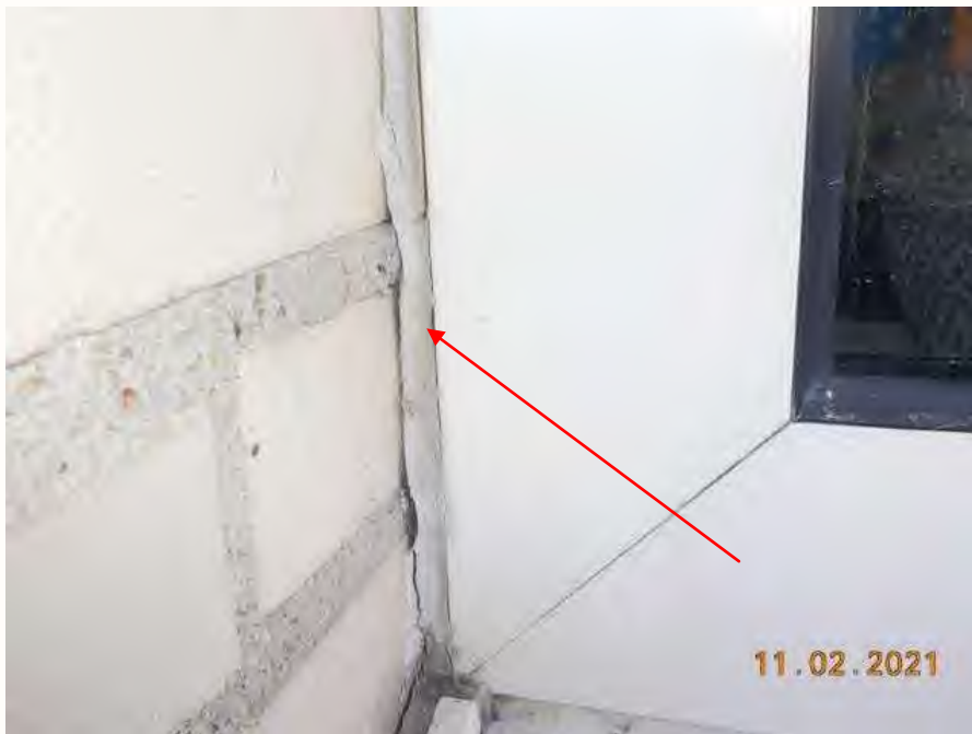
Foto 5: Bron B02, asbesthoudende kit langs aluminium kozijnen met metselwerk
