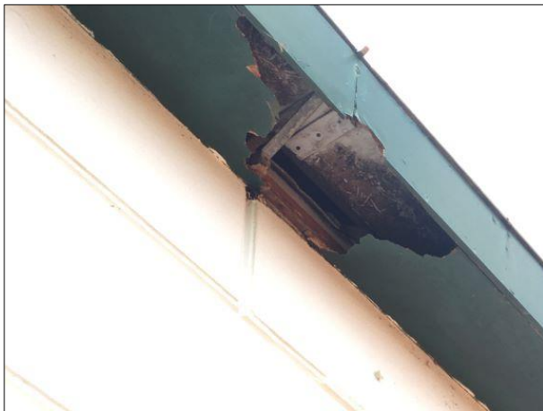
Kauwen nestelen in de holle ruimte onder de dakgoot.
