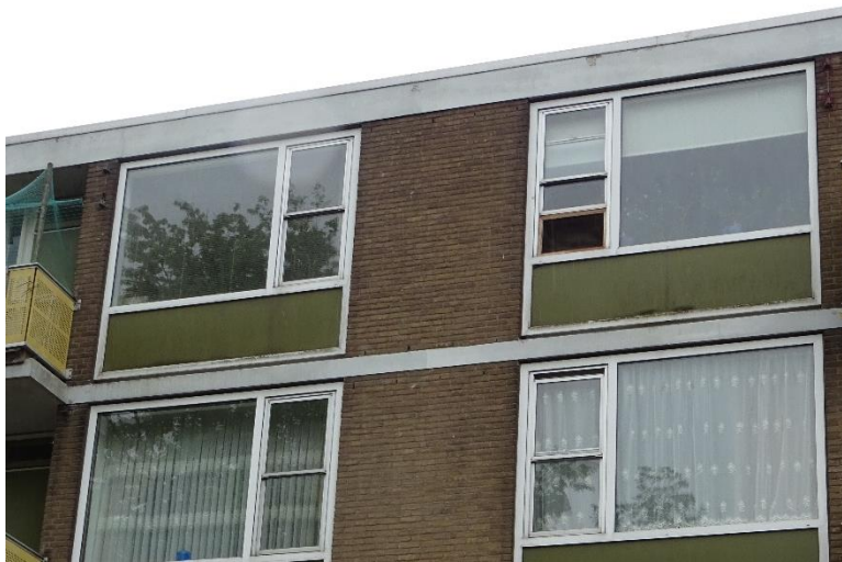
Stootvoegen en openingen tussen de gevelbeplating
