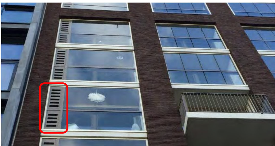
Figuur 5.3: Geluidgedempte ventilatievoorziening in de gevel van een verglaasde loggia ten behoeve van buitenluchtcondities
