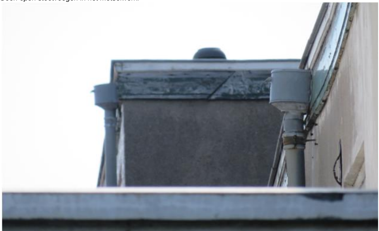
Geen ruimtes tussen daklijst en muur
