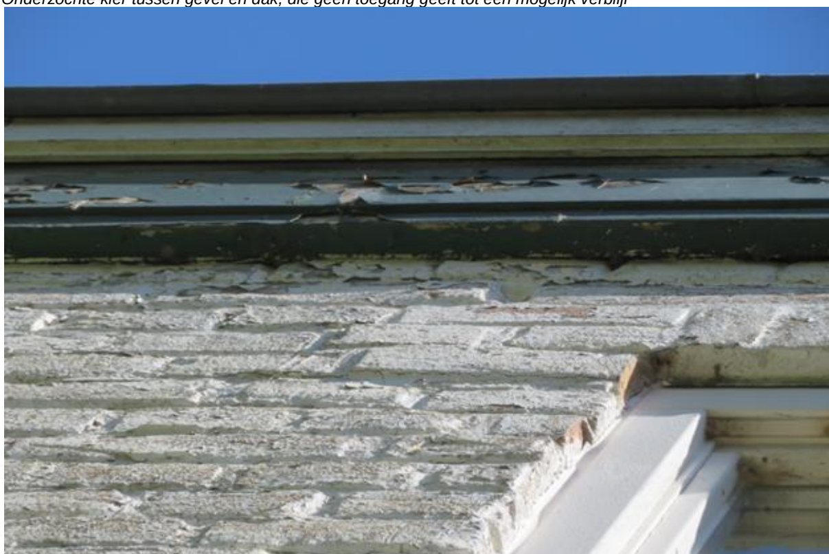
Geen ruimtes tussen daklijst en muur
