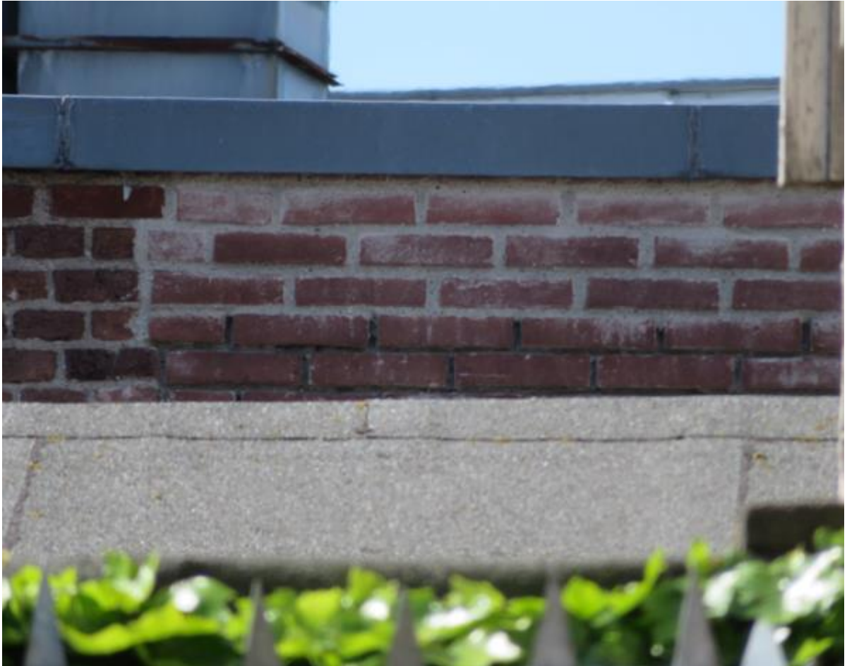
Geen open stootvoegen in het metselwerk.
