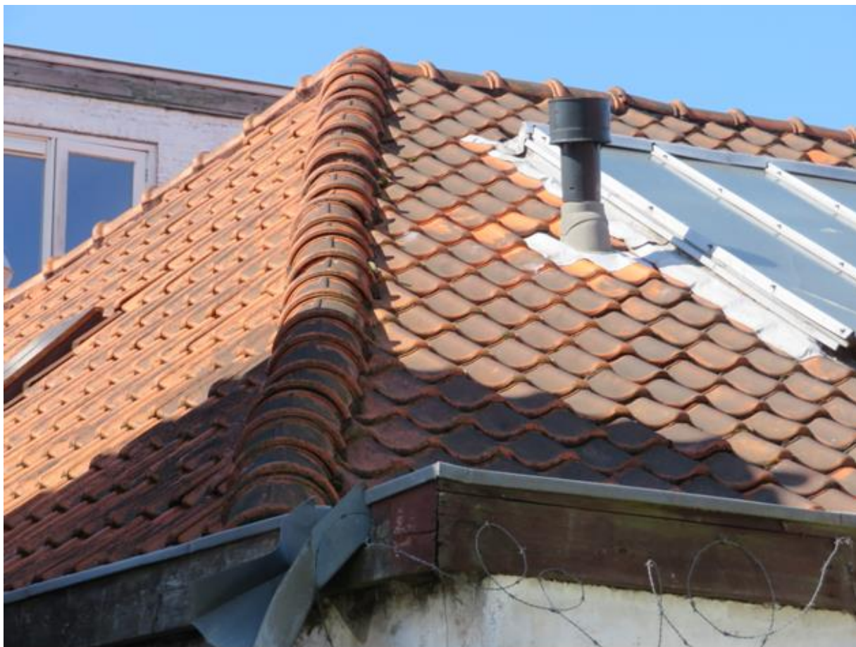
Tussen de pannen is geen ruimte aanwezig voor invliegopeningen.
