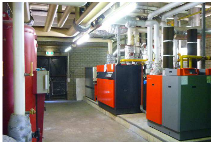
Figuur 14: Huidig ketelhuis (deelloc. 6)
