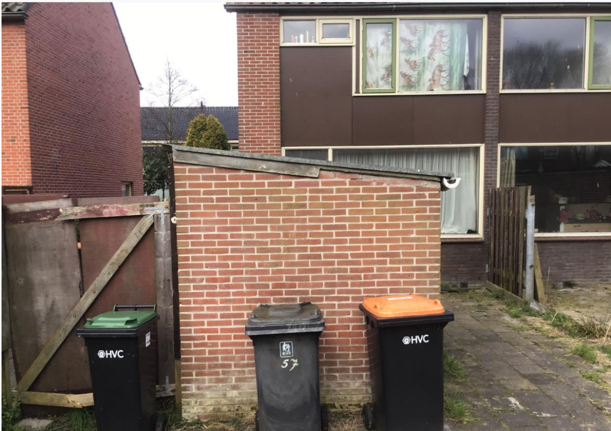
Figuur 3: situatie ter plaatse van een schuur met asbestverdacht dak (achtertuint).
