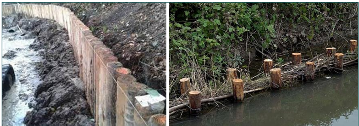
Figuur 11 Een niet natuurvriendelijk geplaatste beschoeiing (links). Doordat de palen strak tegen elkaar zijn geplaatst, kan er geen enkel dier doorheen bewegen. Een natuurvriendelijke geplaatste beschoeiing (rechts), eventueel met toevoeging van wilgentakken. Hierdoor zal achter de beschoeiing een gedeelte met zwakkere stroming ontstaan én kunnen dieren erdoorheen bewegen.
