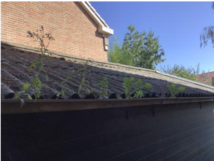
Foto vermoedelijk asbestdak nabij boring 03
