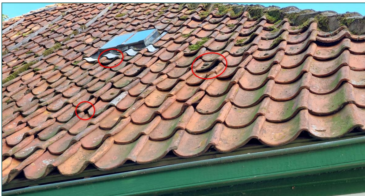
Figuur 3.1 Openingen als scheefliggende dakpannen en openingen tussen daklood kunnen vleermuizen toegang verlenen tot de dakruimten.
