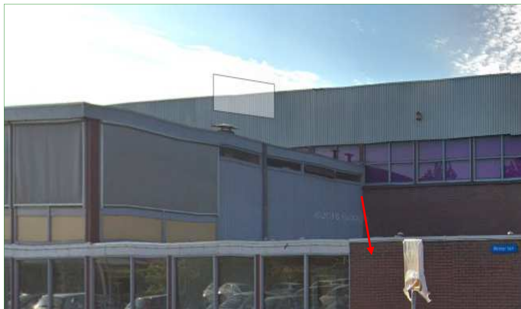
Spouwgat met achterliggende holte waarin in de de vierde bezoekronde een baltsverblijf van Ruige dwergvleermuis aanwezig was.
