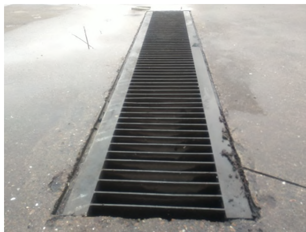
Fotonummer: 2 Omschrijving: Roostergoot in voorziening.
