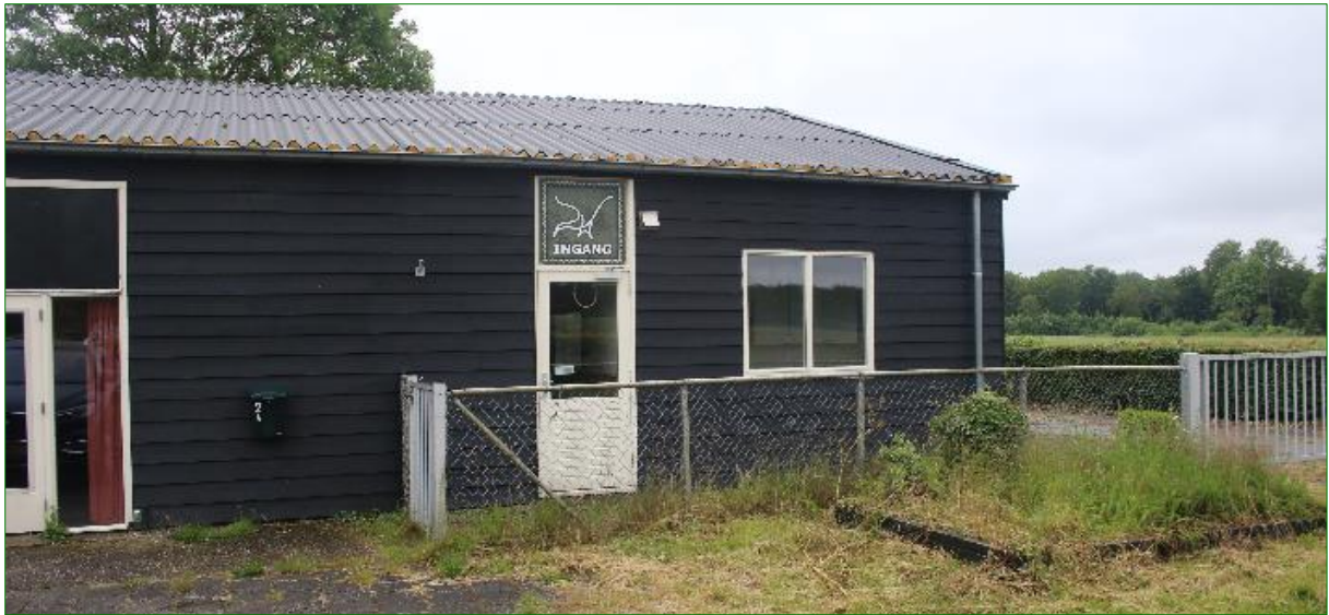
De voorzijde van het pand. Onder de randen van het golfplaten dak is het isolatiemateriaal zichtbaar.
