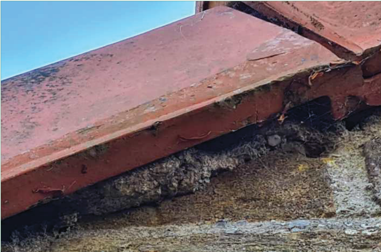
Cement onder de randpannen aan de westgevel van de schuur.
