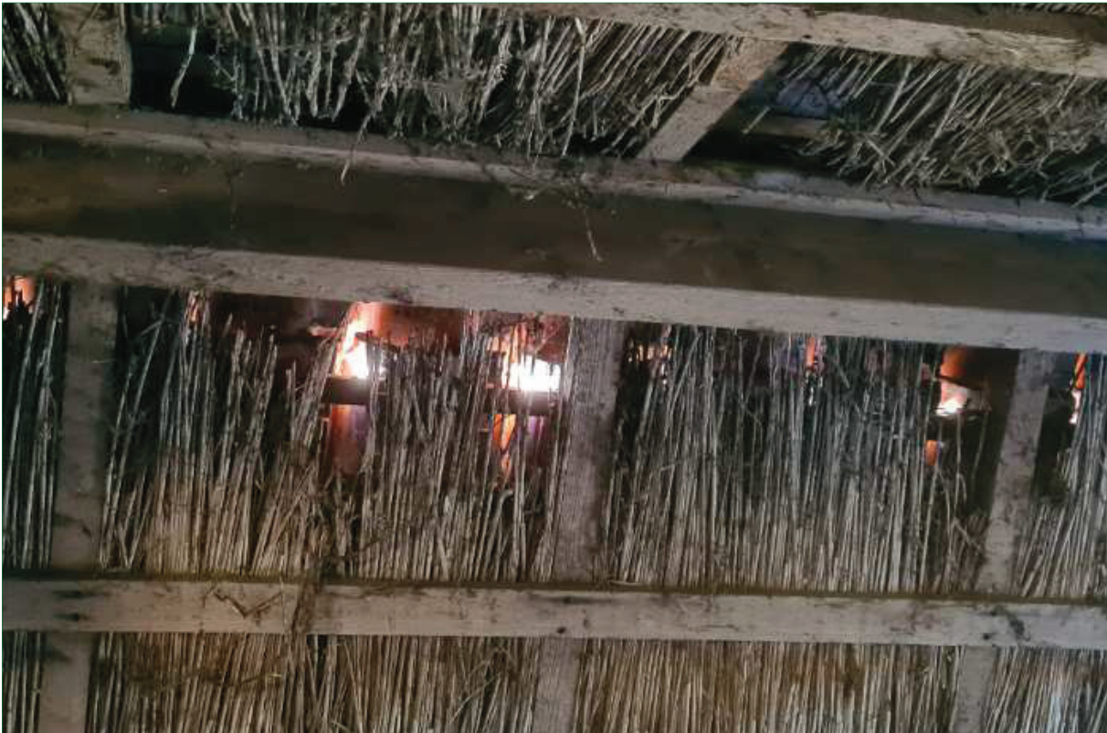
Door de vele gaten in het dak is de schuur te tochtig voor verblijvende vleermuizen.
