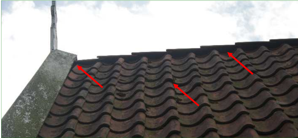
Openingen onder dakpannen geven mogelijk toegang tot voor Huismussen en vleermuizen geschikte achterliggende ruimtes.
