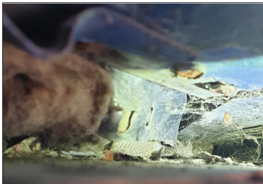
Het gat onder het daklood loopt het niet door naar een achterliggende ruimte.
