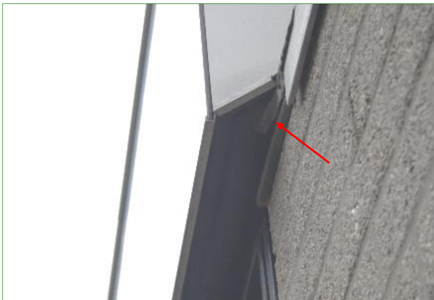
De kieren onder de loodslab boven de bakstenen muur bieden mogelijk toegang tot voor vleermuizen geschikte achterliggende ruimtes.
