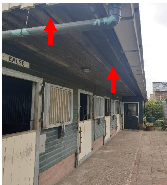
De paardenschuur met kieren onder de overkapping.
