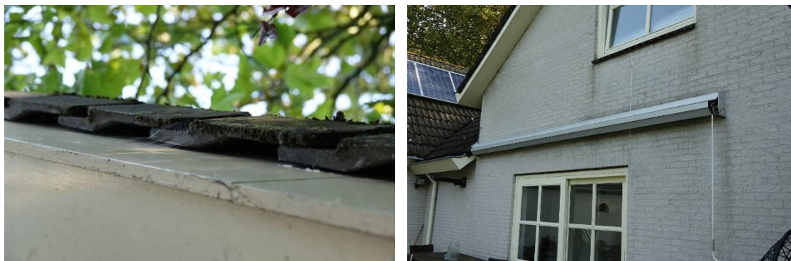
Figuur 9: Close up van de kantpannen die een geschikte opening bieden en één van de twee aanwezige zonneschermen.
