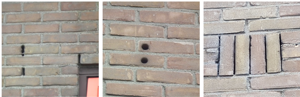
Figuur 2 In het bestaande woonhuis zijn diverse openingen aangetroffen in de stenen gevel waardoor vleermuizen mogelijk de achterliggende spouw kunnen bereiken. Dergelijke openingen vormen potentiële vaste rust- en verblijfplaatsen voor gebouwbewonende vleermuissoorten.
