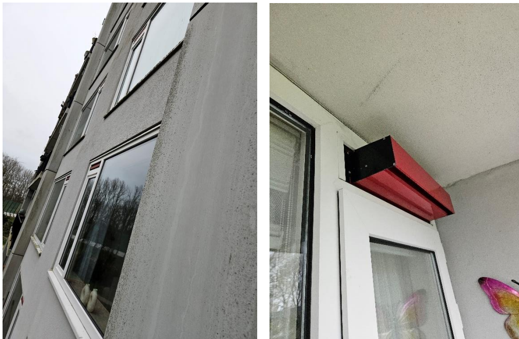
figuur 5: ventilatieroosters (links = woonkamer, rechts is slaapkamer)
