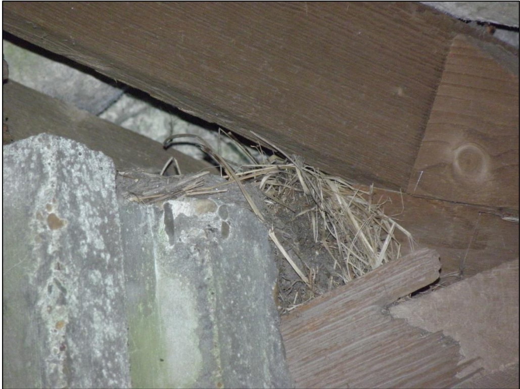
Niet jaarrond beschermd vogelnest aangetroffen in het half open gebouw in het noorden van het plangebied.
