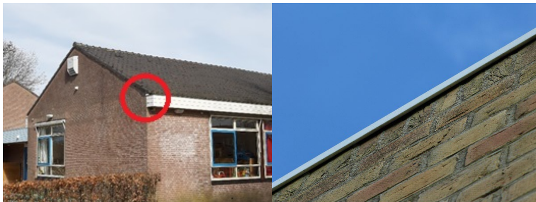
Figuur 5.4 Een zomerverblijfplaats (rood omcirkeld) van een gewone dwergvleermuis op de zuidwesthoek van het schoolgebouw (links) en een zomer- en paarverblijfplaats van gewone dwergvleermuizen onder de dakrand aan de noordwestkant van het dorps huis (rechts)
