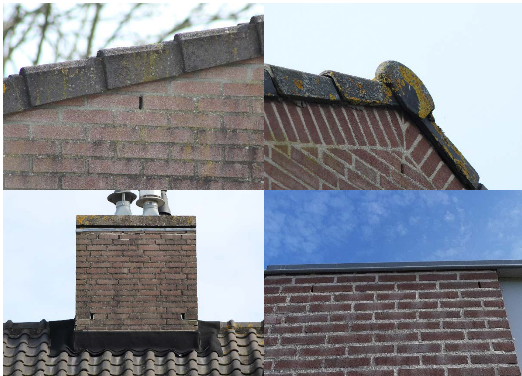
Figuur 3.4 Open stootvoegen en ruimtes onder dakpannen. Van links naar rechts: kinderdagopvang, schoolgebouw, gymzaal en voetbalvereniging
