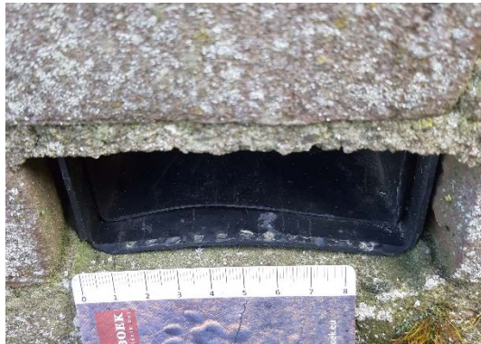
Figuur 3.1 Open ventilatierooster van vier bij tien centimeter
