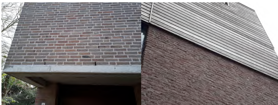
Figuur 5.1 Links spouwsgaten die vleermuizen mogelijk toegang bieden tot Euphrasia, rechts kunnen vleermuizen onder het hout het gebouw mogelijk binnenkomen.
