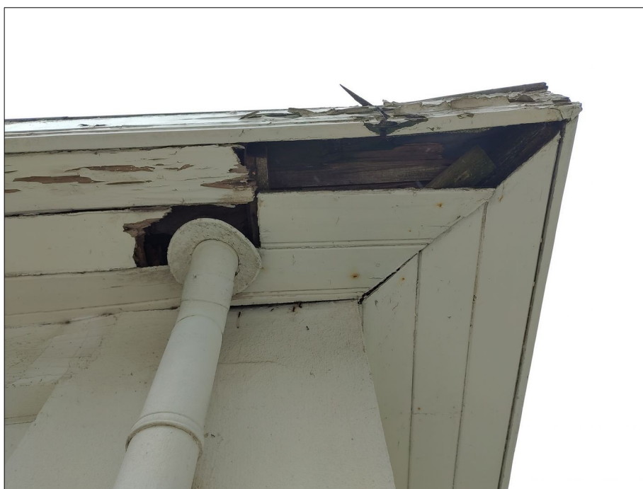
In het dakoverstek bevinden zich meerdere gaten en zijn er kieren tussen het dakoverstek en de buitenmuren aanwezig. Foto: M. van der Neut | Ecoresult B.V.
