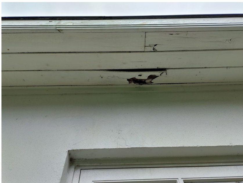
Nog een voorbeeld van kieren en gaten in het dakoverstek. Foto: M. van der Neut | Ecoresult B.V.
