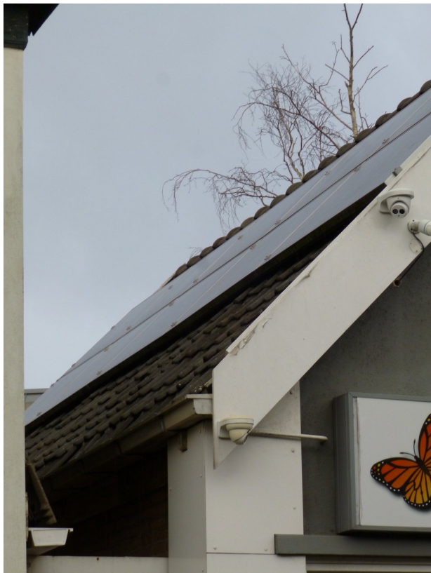
Het dak van Baanstraat 22 heeft een dakpannen bedekking met meerdere scheef- en losliggende dakpannen. Foto: K. de Vries / Ecoresult B.V.
