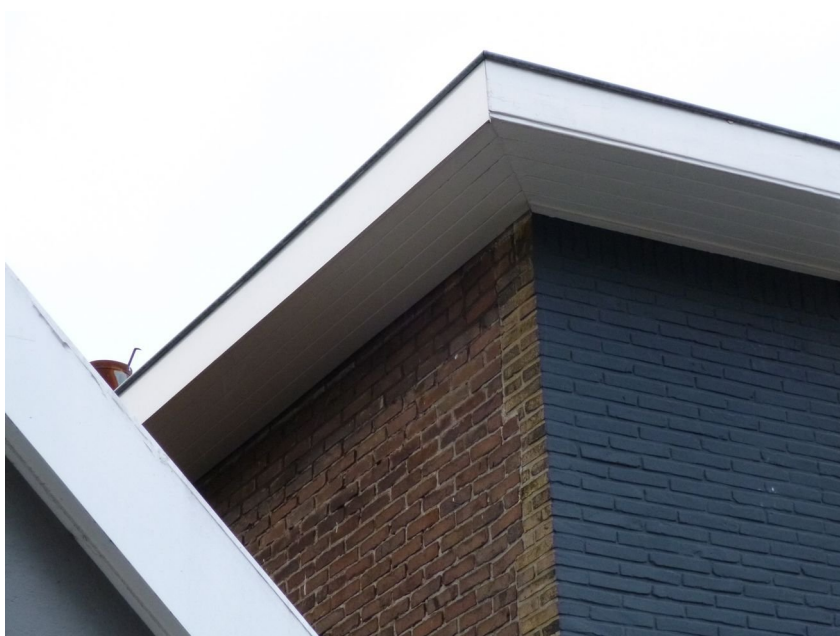
Tussen de buitenmuren en het dakoverstek bevinden zich meerdere kieren. Foto: K. de Vries | Ecoresult B.V.
