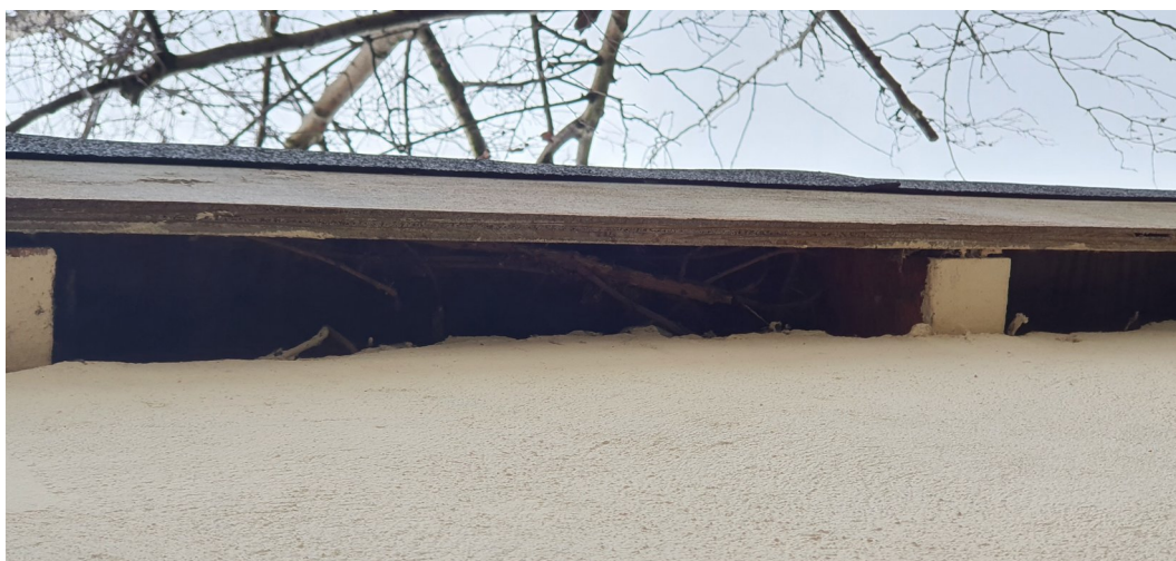
Aan de achterzijde van de uitbouw van Baanstraat 24 bevinden zeer brede kieren tussen de daklat en de buitenmuur. Foto: K. de Vries / Ecoresult B.V.
