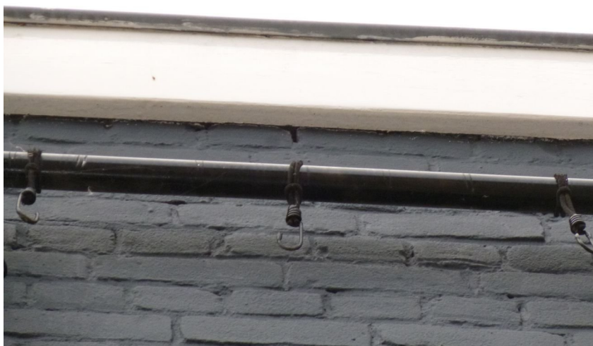
Onder de dakrand bevinden zich enkele open stootvoegen aan de noordgevel van Baanstraat 26. Foto: K. de Vries | Ecoresult B.V.
