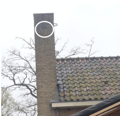
Afbeelding 13. De muren hebben een spouw en in de schoorsteen zijn grote open stootvoegen aanwezig
