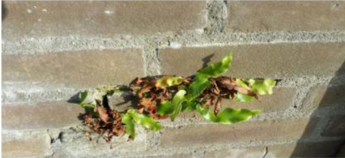
Enkele tongvarens op de westelijke muur van de woning.
