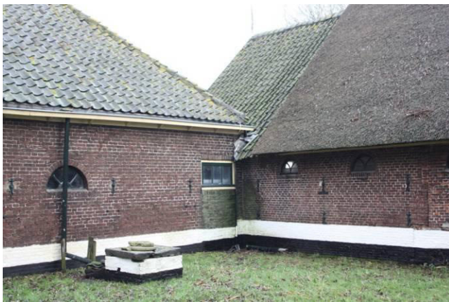
Afb 4.8: gevel t.p.v. overgang veestal-stolp is in slechte staat
