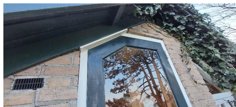
Figuur 8: Bij de deur op de eerste verdieping zijn geen openingen, scheuren of kieren.
