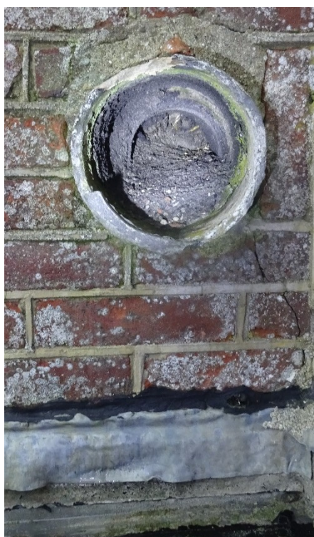
foto 18: Verstopte pijp in de te slopen schoorsteen.
