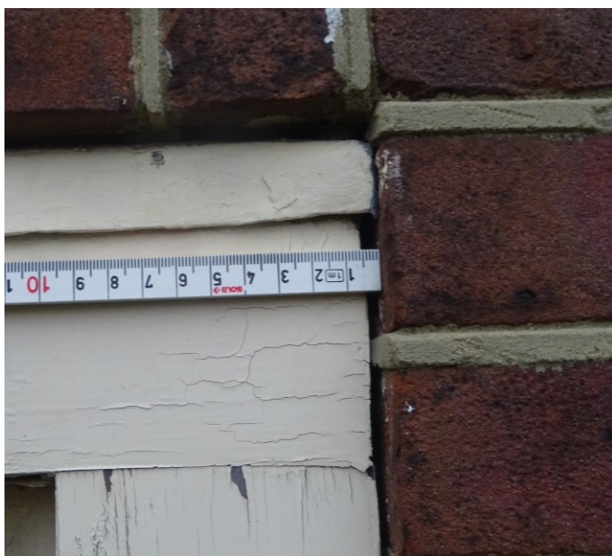
foto 15: Voorbeeld van kier tussen kozijn en metselwerk
