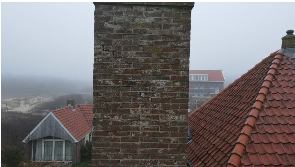
foto 17: uitgevallen voegwerk in de te slopen schoorsteen.
