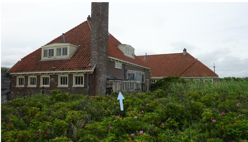
Foto 5: Vervallen uitbouw aan westgevel "Koloniehuis".
