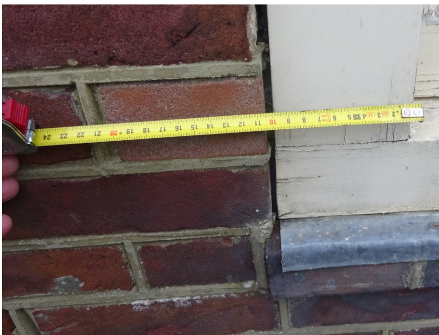
foto 14: Voorbeeld van kier tussen kozijn en metselwerk
