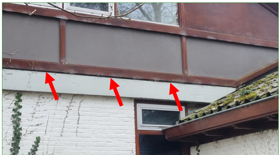
De openingen onder randpannen en tussen gevelbetimmering (rode pijlen) van de vrijstaande woning geven mogelijk toegang tot voor vleermuizen geschikte achterliggende ruimtes.
