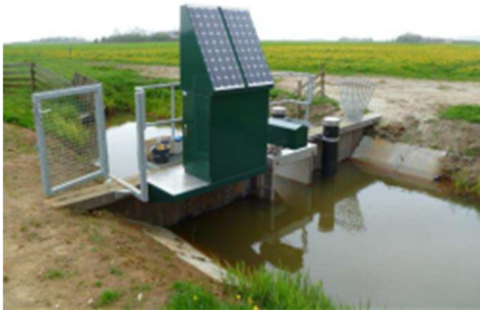
Foto B: voorbeeld geautomatiseerde stuw met zonnepaneel
