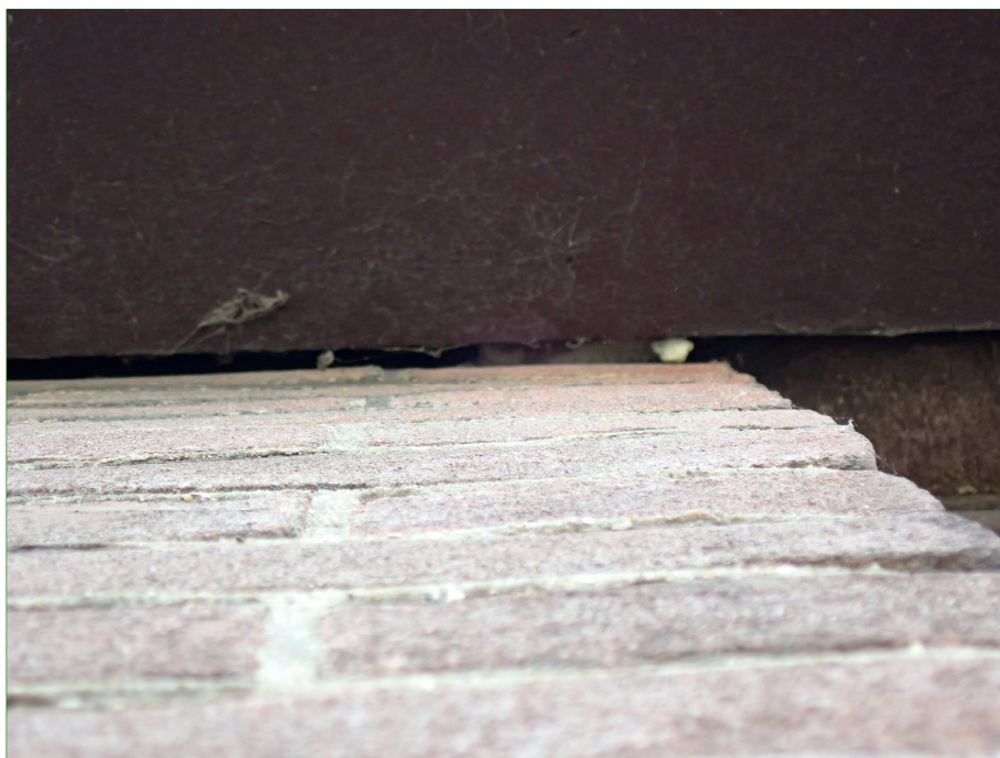
Spleten onder daklijsten kunnen toegang geven tot voor vleermuizen geschikte holtes..
