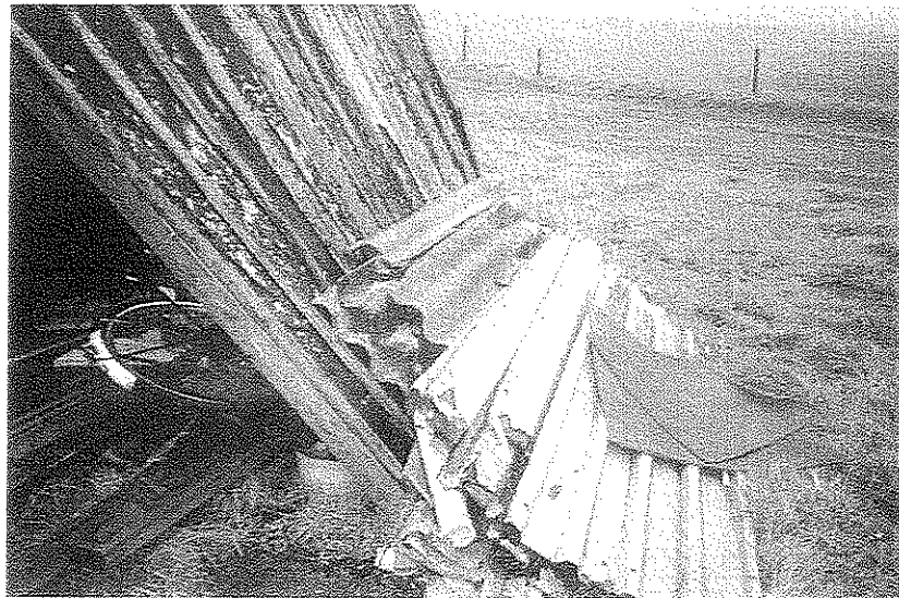
Foto 6 Deelgebied 1, asbestplaten en afval op maaiveld
