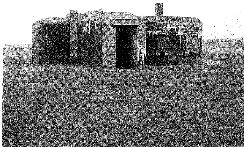
Foto 31 Deelgebied 2, bunker op westelijk terreindeel (asbestbrokjes op maaiveld)
