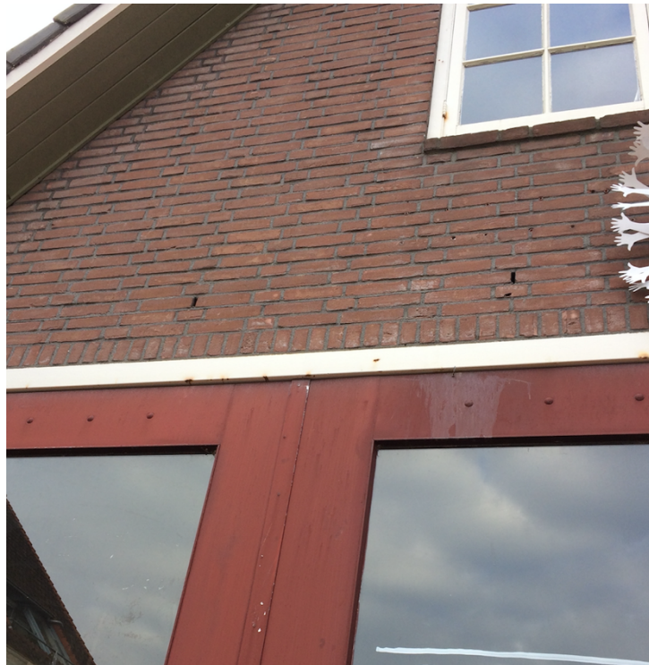
Afbeelding 15. Open stootvoegen in de gevel van de brandweerkazerne
