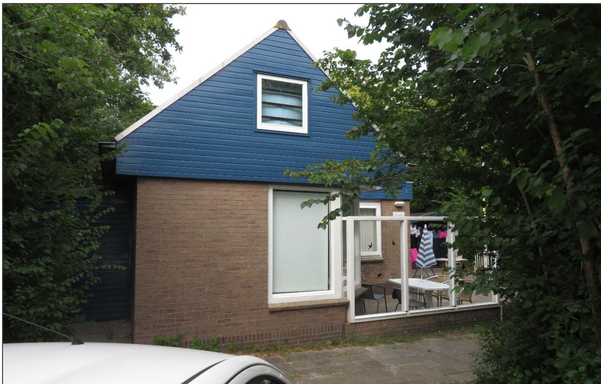
Afb 17: Open stootvoegen in metselwerk ontbreken
