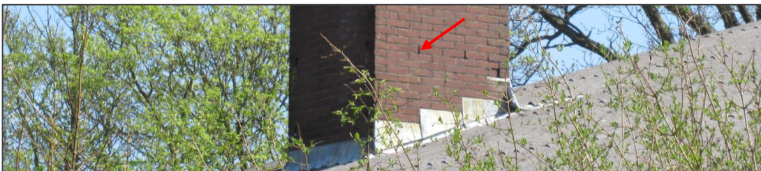
Figuur 12. Detail van open stootvoegen in schoorsteen van voormalig clubgebouw.
