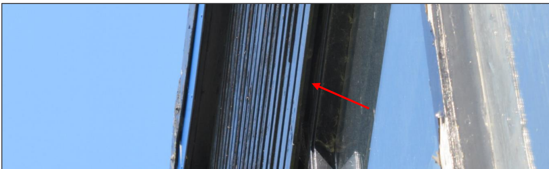
Figuur 13. Ruimte achter boeibord en gevelbekleding van voormalig clubgebouw.
