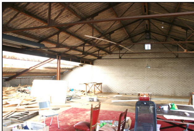
Binnenzijde van één van de loodsen met opgeslagen materiaal. Dakbetimmering ontbreekt.
