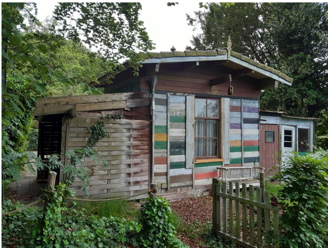
Achterzijde vervallen woonhuis
