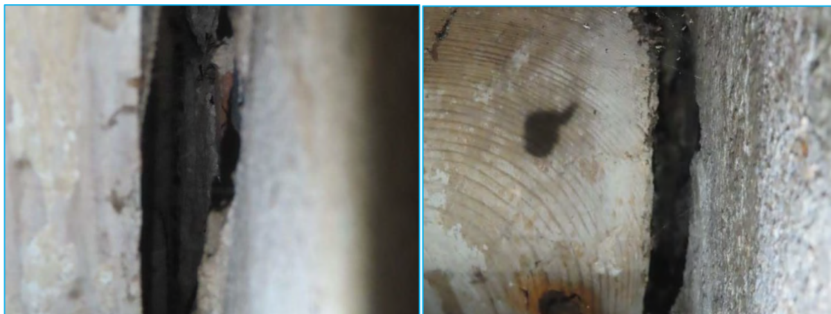
Foto's: aanwezig scheuren kelder, kamer 2.
