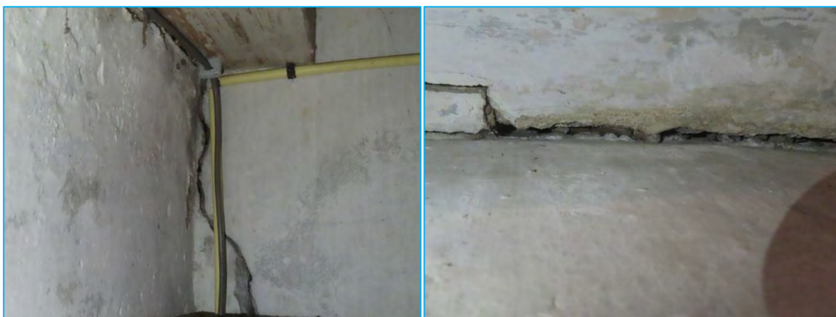
Foto's: aanwezig scheuren kelder, kamer 1.
