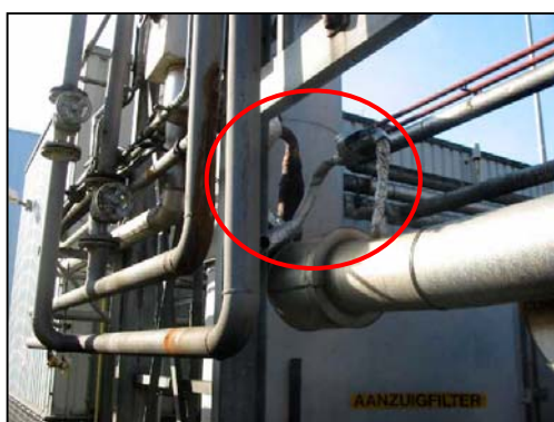
Zuidzijde terugwininstallatie west
