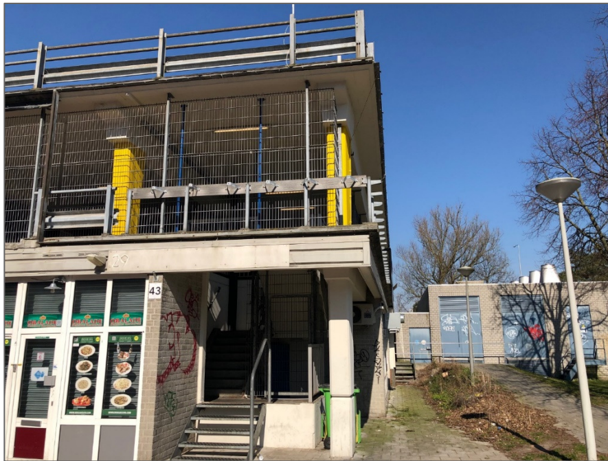
Afbeelding 6.2: De kier achter de bebording is aan beide zijden open, hierdoor ontstaat een ongeschikte tochtige situatie
