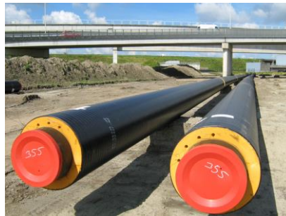
Geïsoleerde leidingen t.b.v. warmtenet
