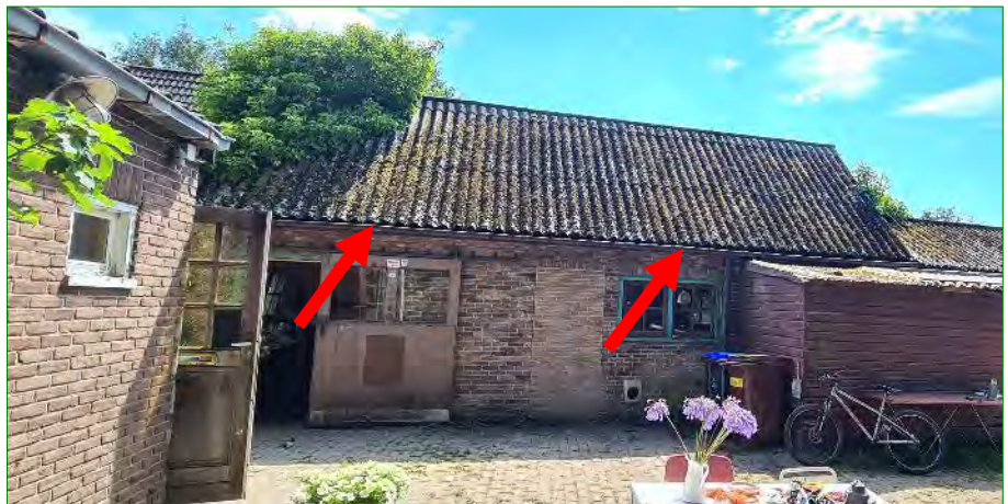
De openingen onder de dakpannen onder de dakpannen van het woonhuis en de golfplaten van de stenen schuur (rode pijlen) geven mogelijk toegang tot voor Huismussen geschikte achterliggende ruimtes.
