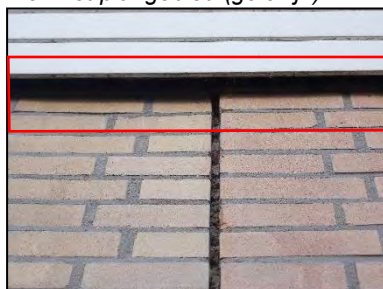
Figuur 9. Detail opening onder dakrand (rood rechthoek) en verticale spleet in muur.
