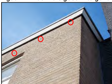
Figuur 8. Open stootvoegen (rode cirkel) en opening onder dakrand.
